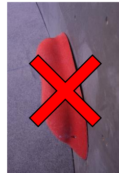
Bild 5 unzulässige Befestigung an einer konkaven Wand
